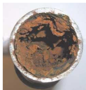
Obr. 4: Zanášení kovového potrubí [14]
