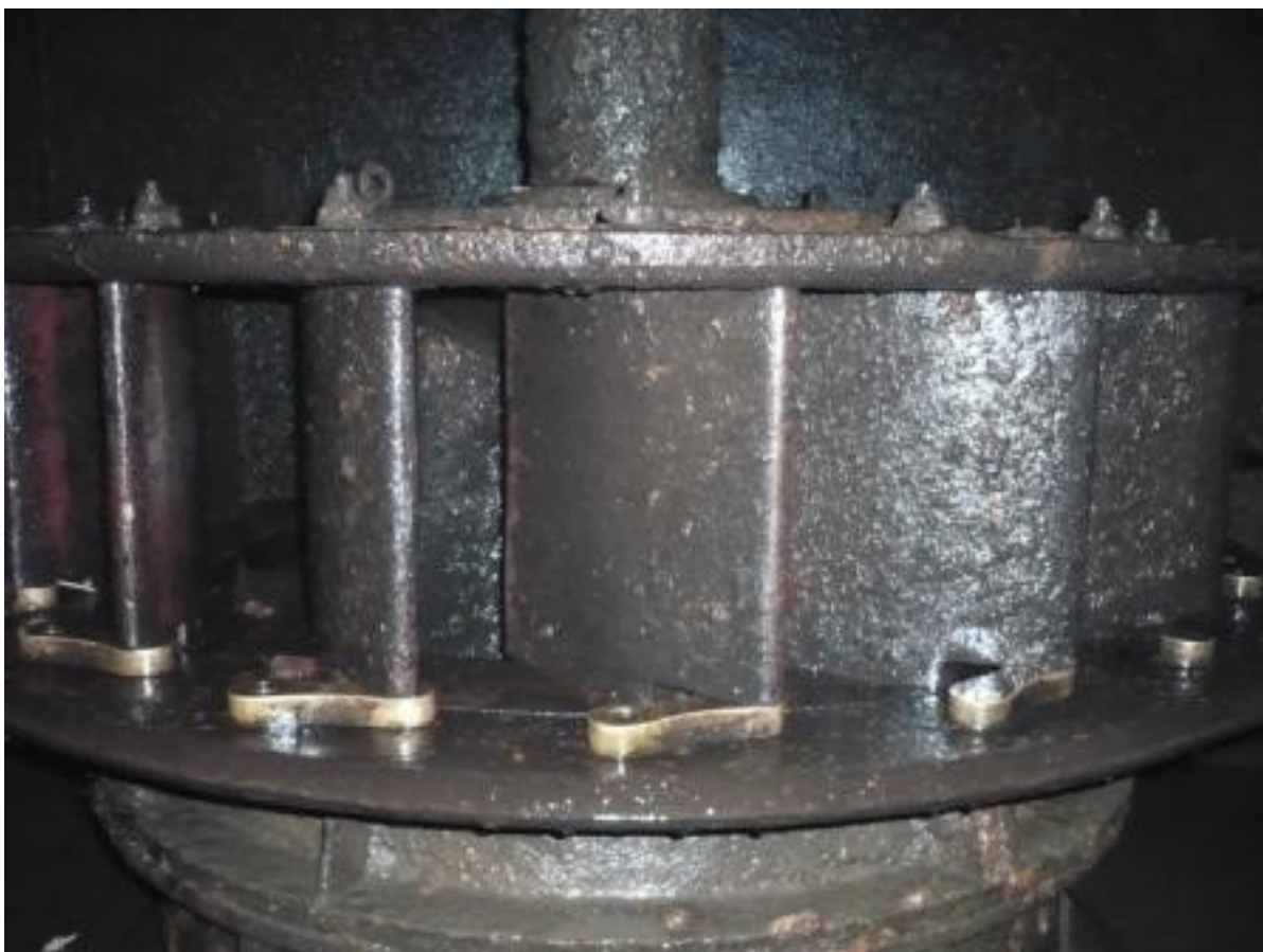
Obr. 13: Instalovaná Francisova turbína s detailem lopatek, jejichž naklápěním je možné regulovat výkon turbíny (Zdroj: fotografie autora).
