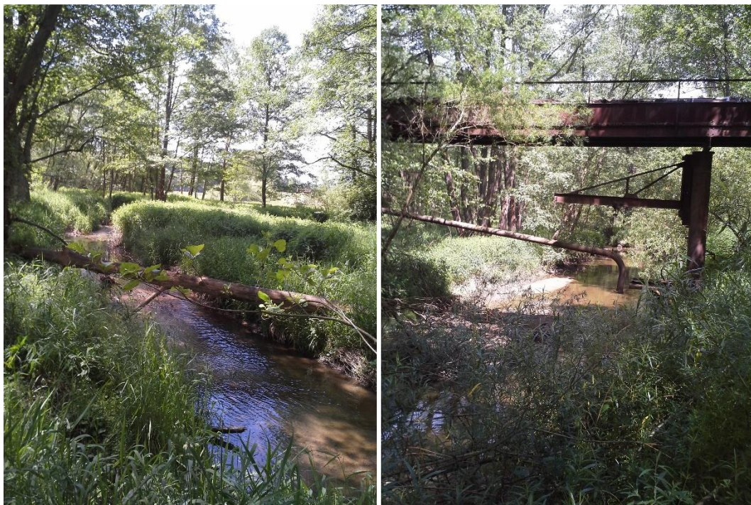
Příloha 8: Přírodní koryto Bezdrevského potoka nad rybníkem Mnich (lokalita č. 5) nedaleko Netolic – na druhém snímku je pohled na polorozpadlou konstrukci (pozůstatek grafitových závodů) (foto M. Let)
