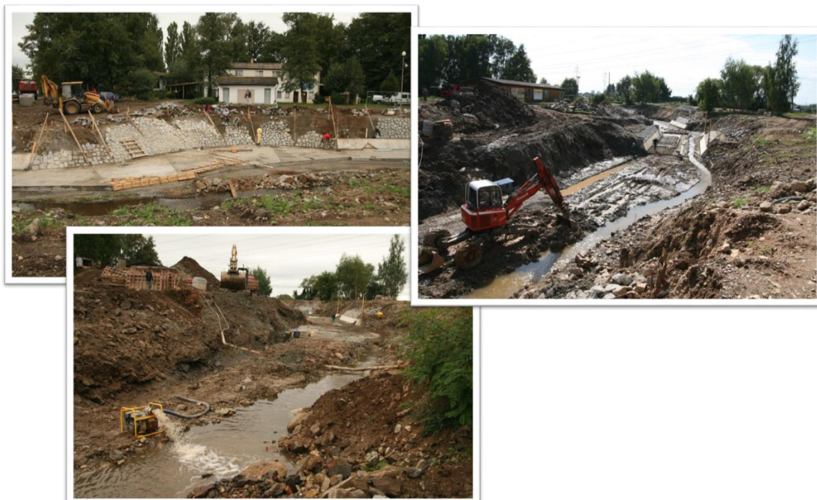
Obrázek 80. Další fotografie z průběhu stavby nového kanálu. Vpravo a dole je vidět stavbu divácky nejatraktivnějšího úseku kanálu u loděnice. Osobní archiv Jakuba Prühera.
