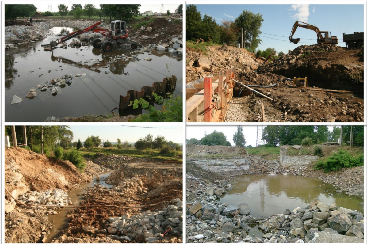
Obrázek 78. Na fotografiích je vidět průběh stavby nového kanálu v jejích začátcích. Vpravo dole je pak vidět bourání Kolovadla , jehož se dříve kanoisté tak obávali. To se následně stalo díky kvalitě a množství betonu použitého na jeho konstrukci noční mûrou dělníků, kteří jej bourali. Osobní archiv Jakuba Prûhera.
