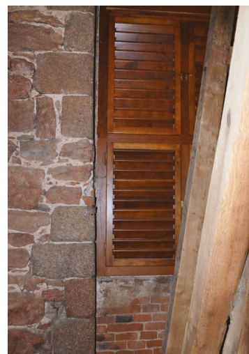
26/ Pozůstatky dvou-etážového zakončení zvonice.
