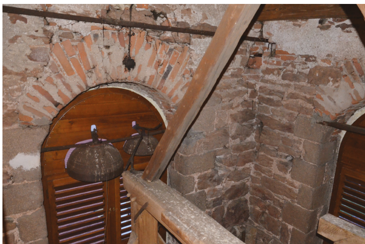
27/ Pozůstatky dvou-etážového zakončení zvonice.
