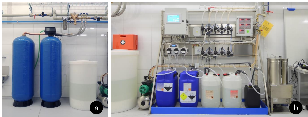
obr. 5–7: Úpravna vody (a) a systém dávkování prací chemie (b)
