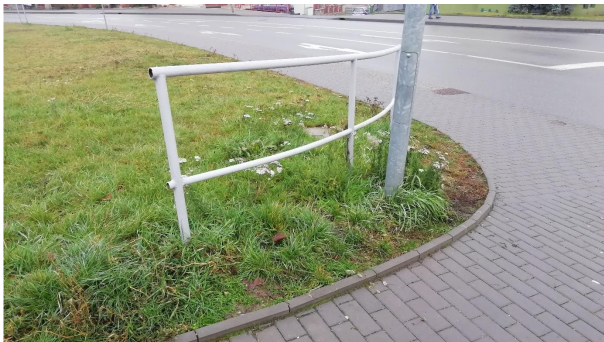
Obrázek 8.24 Zábradlí na nároží 1. Máje sever a Sokolská, vzdáleno min. 0,5 m od chodníku (nepoužitelné-odstranit, posunout)
