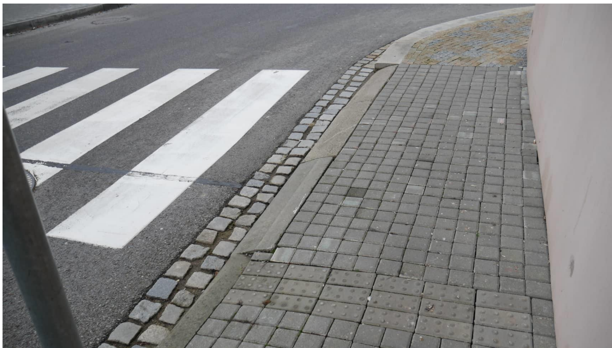
Obrázek 8.25 Chybějící prvky bezbariérového užívání stavby (pohled ke křižovatce, ul. Sokolská)
