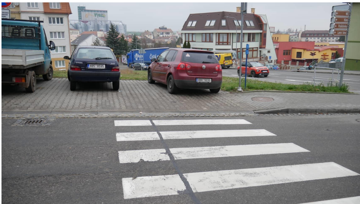
Obrázek 8.26 Chybějící prvky bezbariérového užívání stavby (ul. Sokolská)
