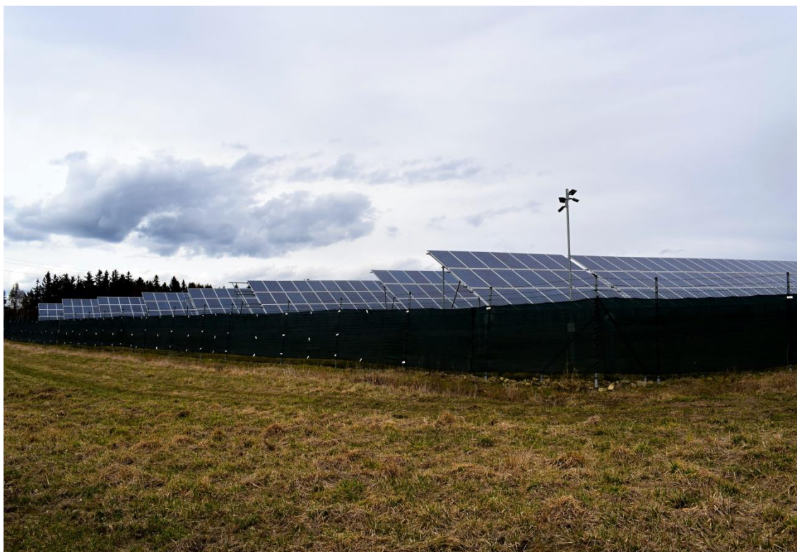
Obr. 57: FVE lokalizovaná v zalesněném prostředí na území obce Brněnec Zdroj: P. Dřímál (březen 2018)
