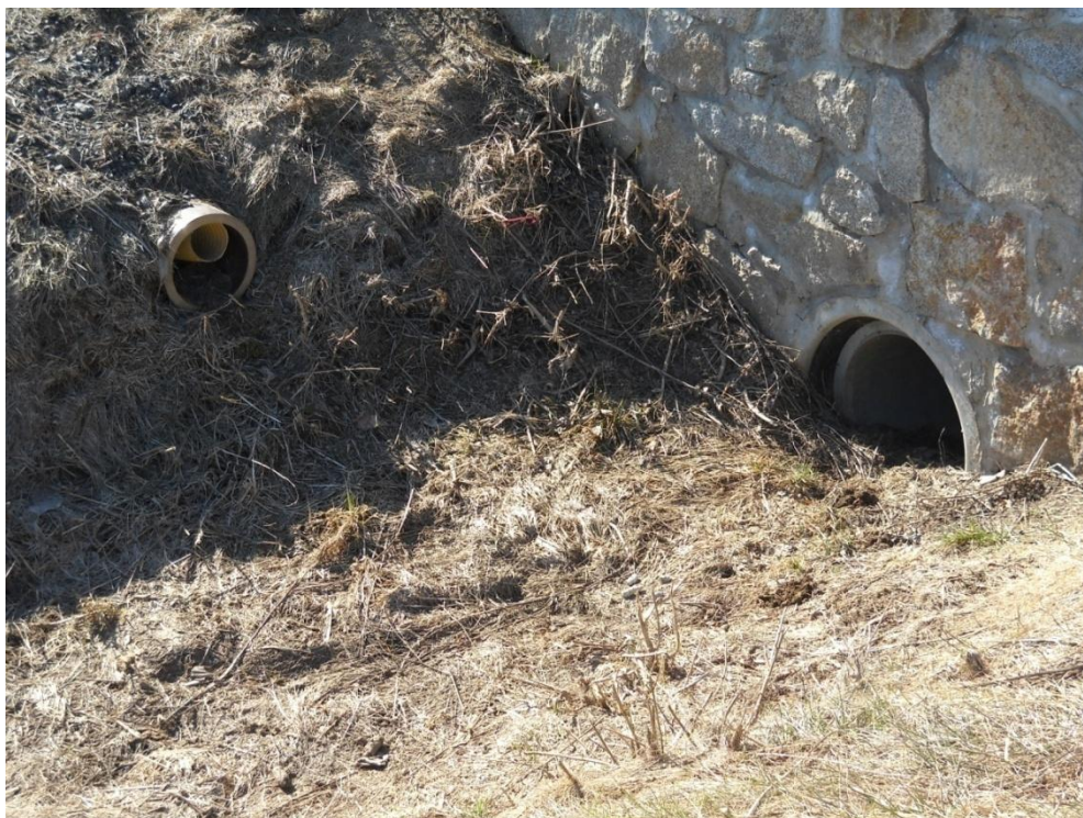
Foto 5 Detail částečně zaneseného propustku, příkop A2.
