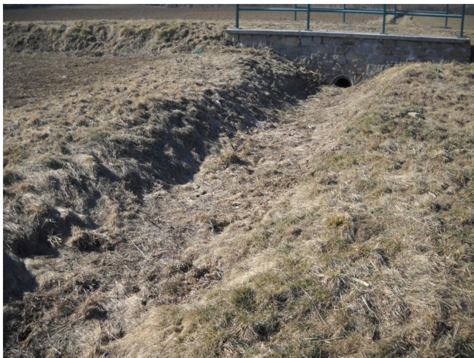
Foto 4 Zanášení propustku pod cestou, příkop A2.
