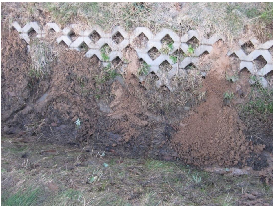
Foto 3 Zanášení příkopu A2 zeminou vyplavenou otvory v polovegetačních tvárnících.
