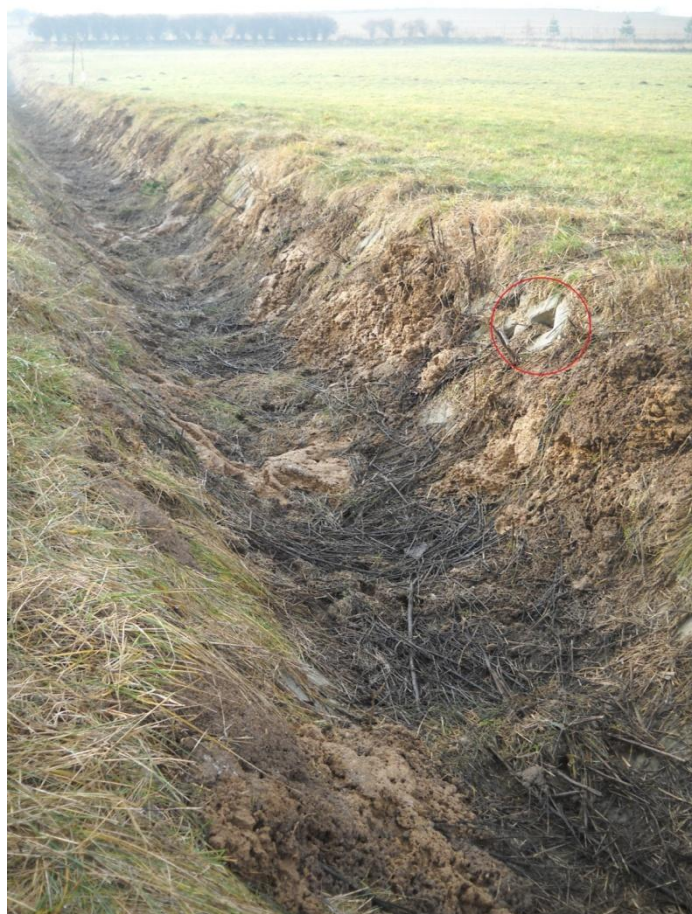
Foto 2 Vyplavování zeminy otvory v polovegetačních tvárnících, příkop A.
