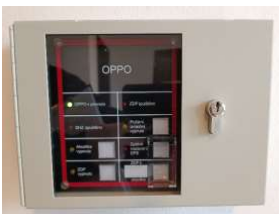
Obr. č.5: OPPO v zádveři objektu
