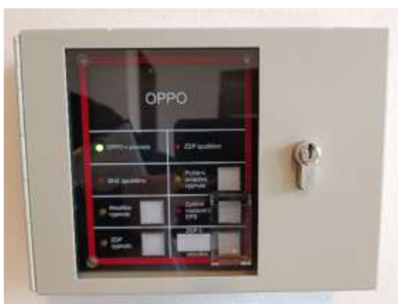
Obr. č.5: OPPO v zádveři objektu
