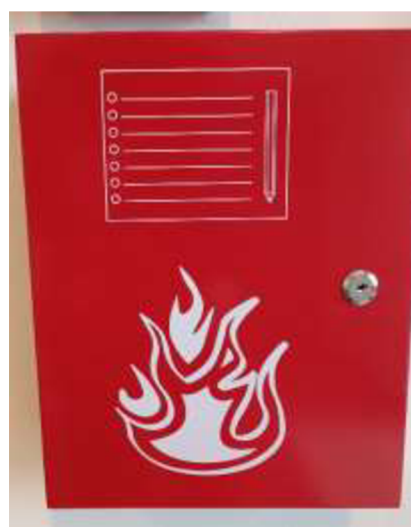
Obr. č.6: Skříňka na dokumentaci v zádveři objektu
