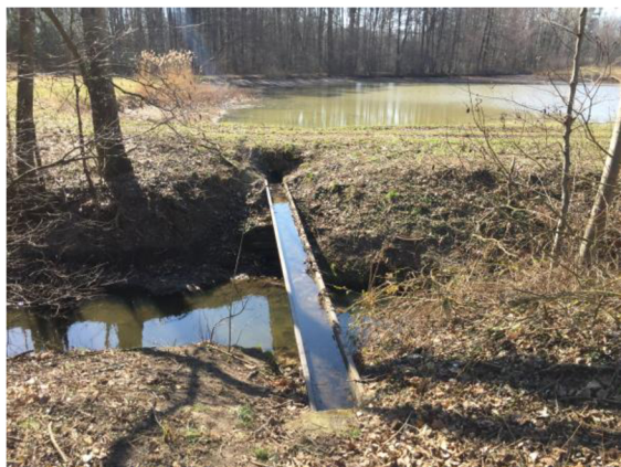
Obr.č.21. Přívodní ocelový žlab ze Sopřečského rybníku do rybníku Mladinový přes Sopřečský potok.
