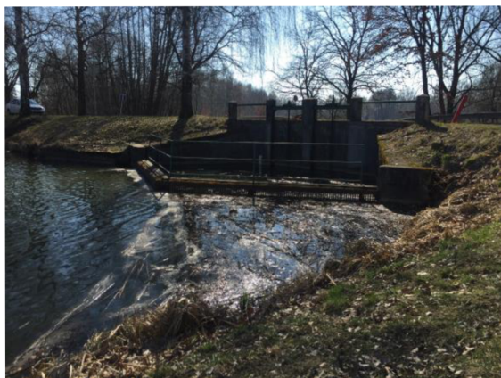
Obr.č.13. Výpustní objekt Bohdanečského rybníka
