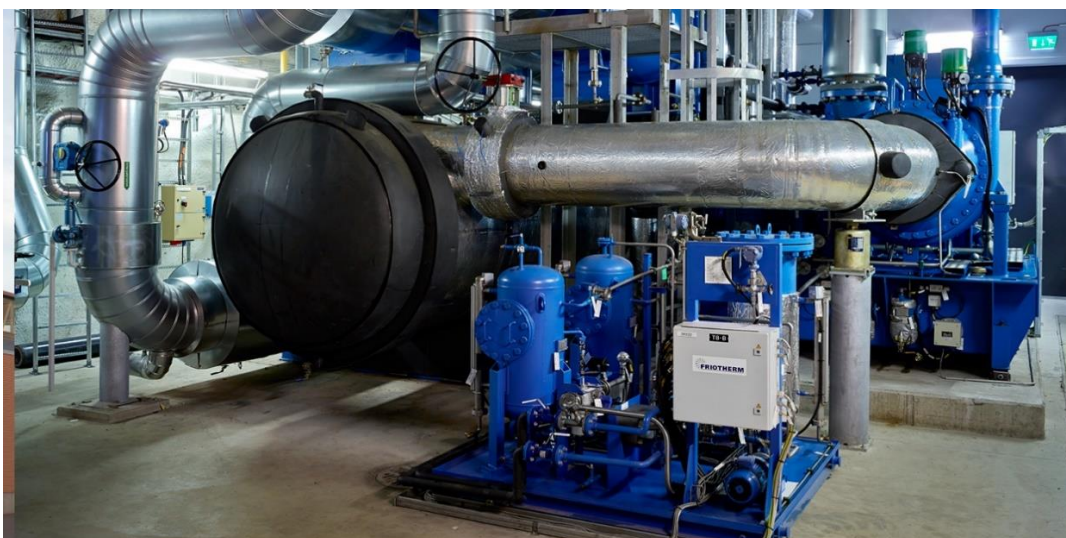
Obrázek 3.5 Tepelné čerpadlo v zařízení Katri Vala [47]
