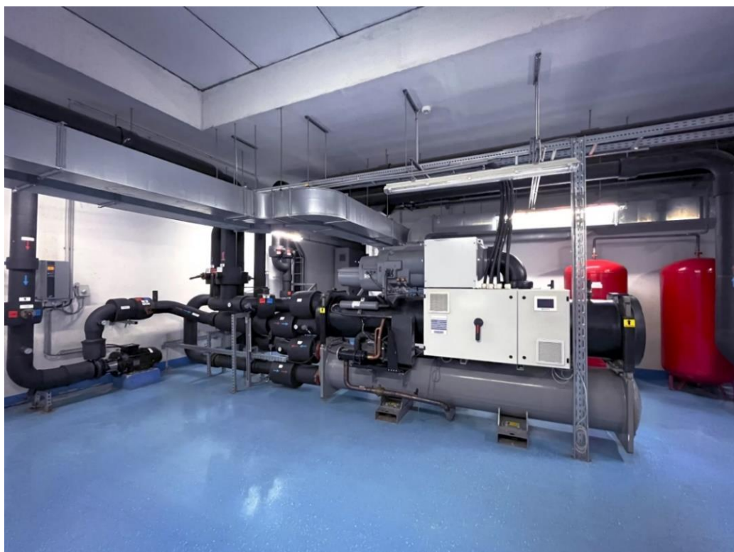
Obrázek 3.4 Průmyslové tepelné čerpadlo v Budapešti [46]
