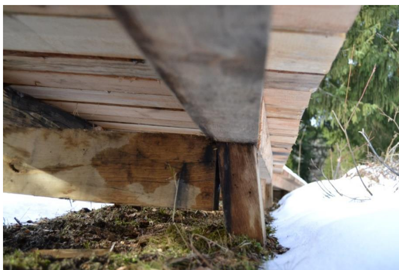
Obrázek 15 - Detail dřevěných roštů u dřevěného povalového chodníku v Hornovltavických pastvinách. Foto: autor
