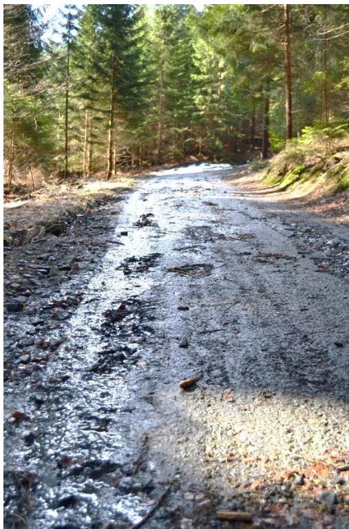
Příloha 3 - Ukázka špatně odvodněného chodníku. Na povrchu vznikají díry v důsledku působení povrchové vody.
