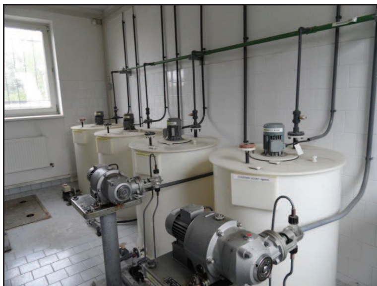
Obr. 23 Neutralizační stanice s nádržemi
