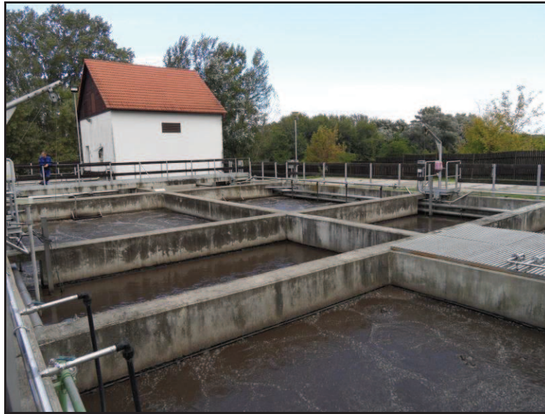
Obr. 26 Předřazená denitrifikační nádrž
