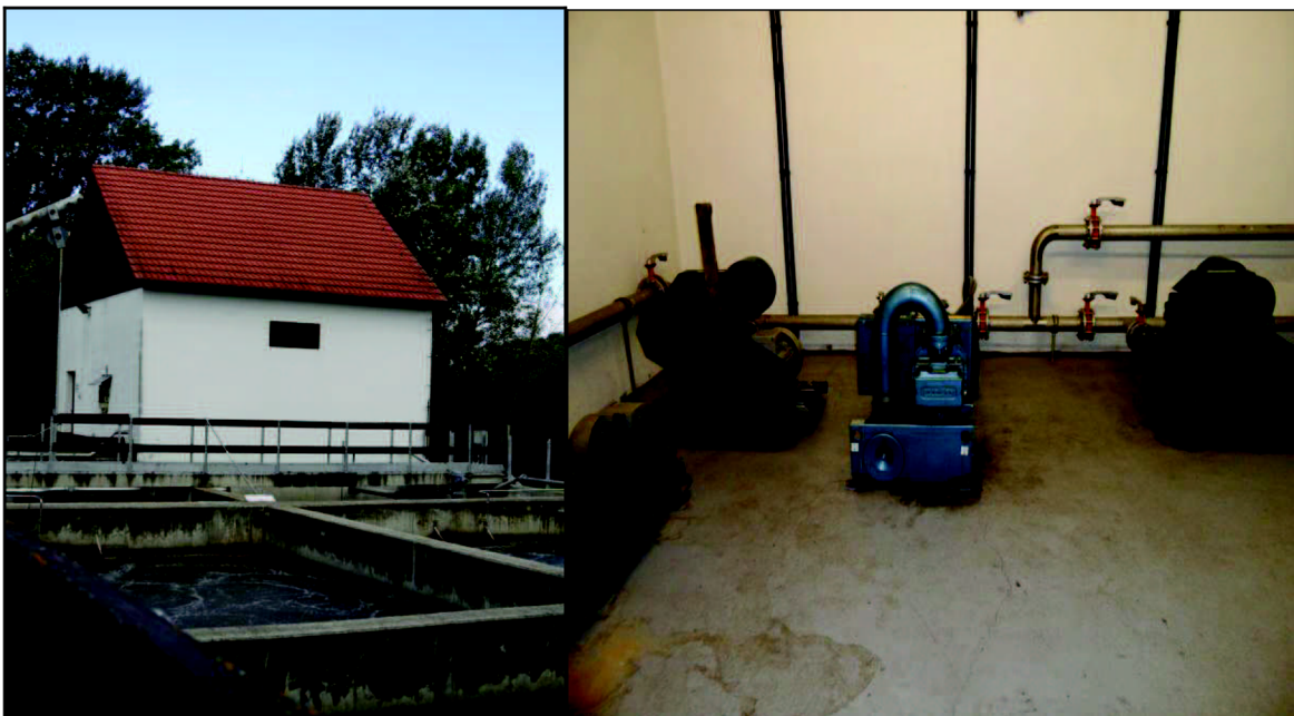
Obr. 29 Dmychárna a její vnitřní prostor
