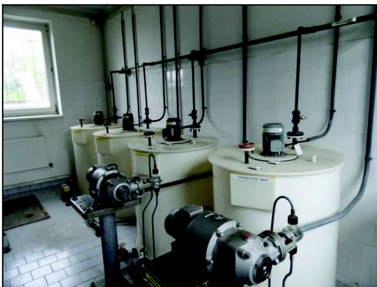
Obr. 23 Neutralizační stanice s nádržemi
