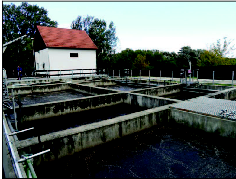
Obr. 26 Předřazená denitrifikační nádrž
