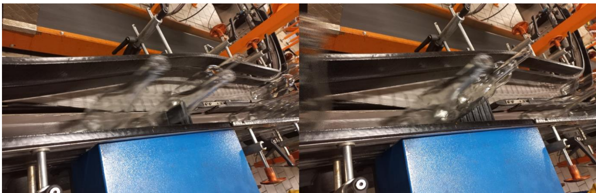
Obr. 11 Přesměrovávací zařízení na lince 21
