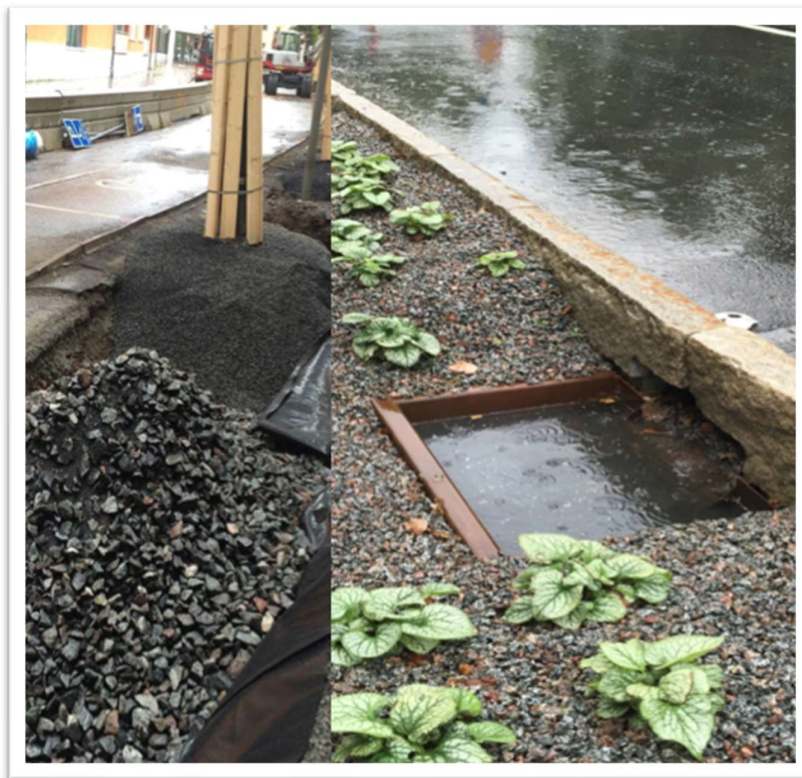
Obr. 7 Livable streets – A handbook of Bluegreengrey systems – Edge Vlevo otevřená konstrukce základní vrstvy s biouhlem, který funguje jako výsadbový záhon a nádrž na dešťovou vodu. Vpravo vpust' do bioretenčního místa s lapačem písku, který zachytává sedimenty před tím, než se dešťová voda vsákne do záhonu.
