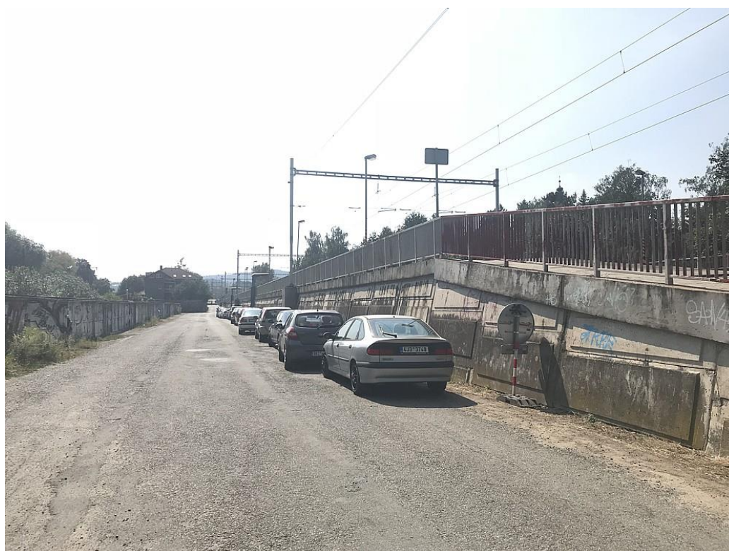
Obrázek č. 4 – Pohled na opěrnou zeď za 1. nástupištěm v zast. Blansko město
