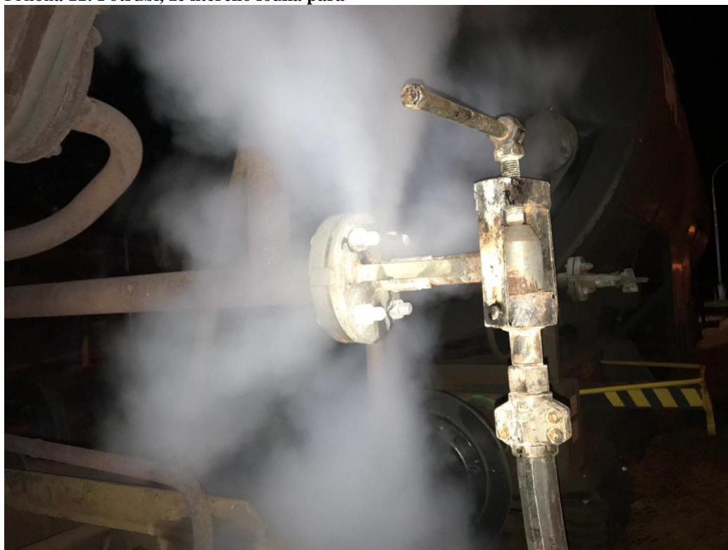
Příloha 11: Potrubí, ze kterého fouká pára
