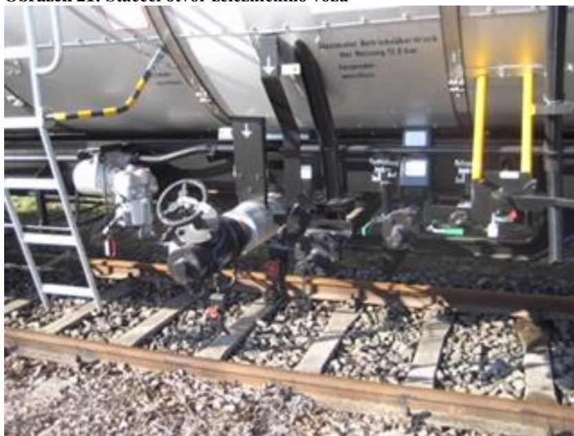
Obrázek 21: Stáčecí otvor železničního vozu
