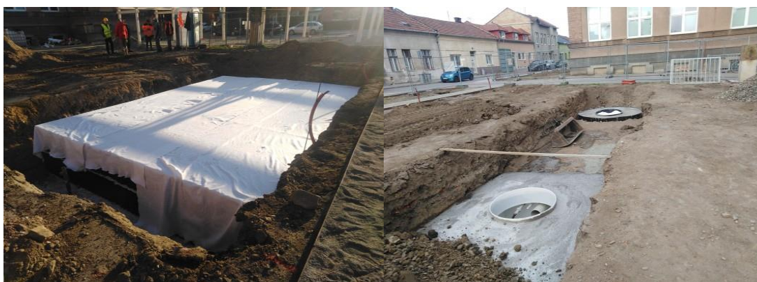
Obr. 36: Retenční nádrž a akumulací nádrž se vsakovací šachtou (zdroj: Magistrát města Prostějova, 2022)
