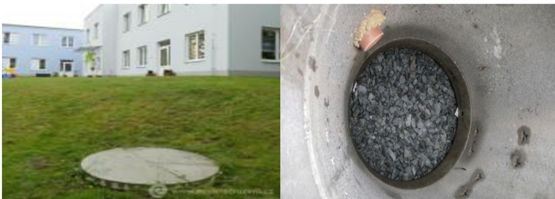
Obr. 33: Vsakovací šachta v Plzni v mateřské škole na ul. Staniční (zdroj: Envic, 2023)
