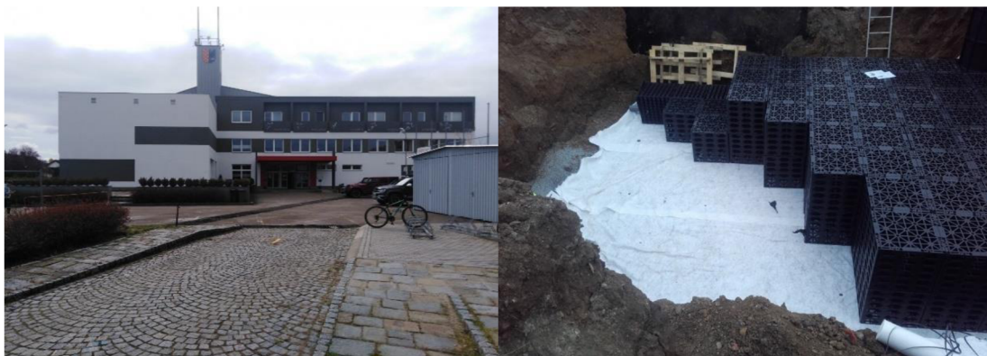
Obr. 28: Budova Sportcentra v Prostějově a vsakovací nádrž složená z bloků v průběhu instalace (zdroj: Magistrát města Prostějova, 2021)
