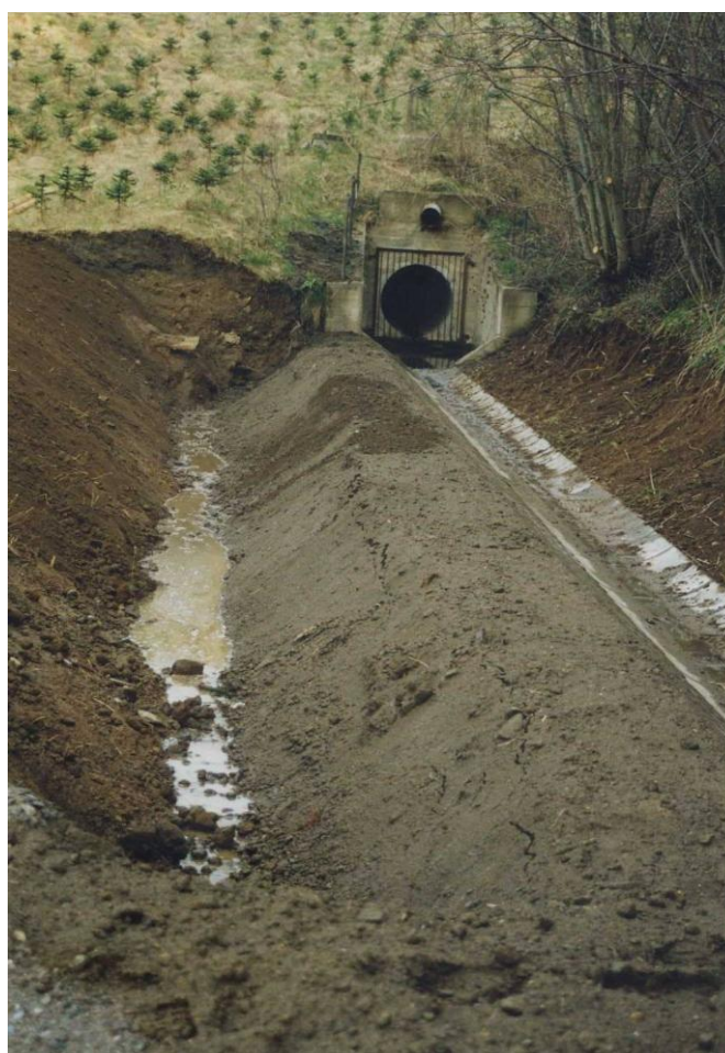
Foto 12: Vyústění zatrubněné vodoteče a drenáže kontaminovaných vod pod odvalem Olší (duben 1998, archiv s. p. DIAMO)
