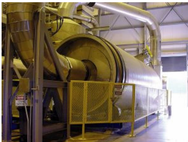
Obr. 19 Bubnová sušárna odvodněného kalu [15]
