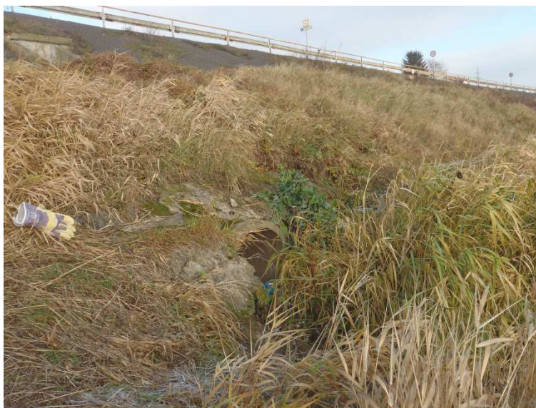
foto č. 4 Kanalizační výust' DC4 (zdroj: vlastní)
