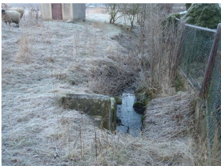
foto č. 7 Kanalizační výust' - DC8 (zdroj: vlastní)
