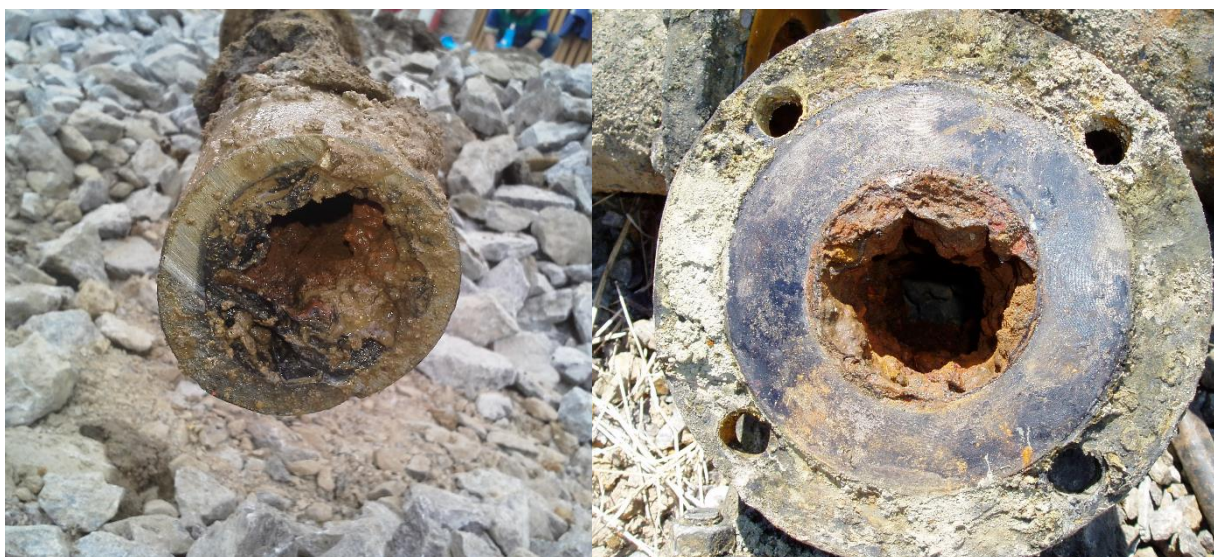
Obr. 2.12 Výřez potrubí GG 100 mm z roku 1965 se silnou inkrustací (foto duben 2015).
