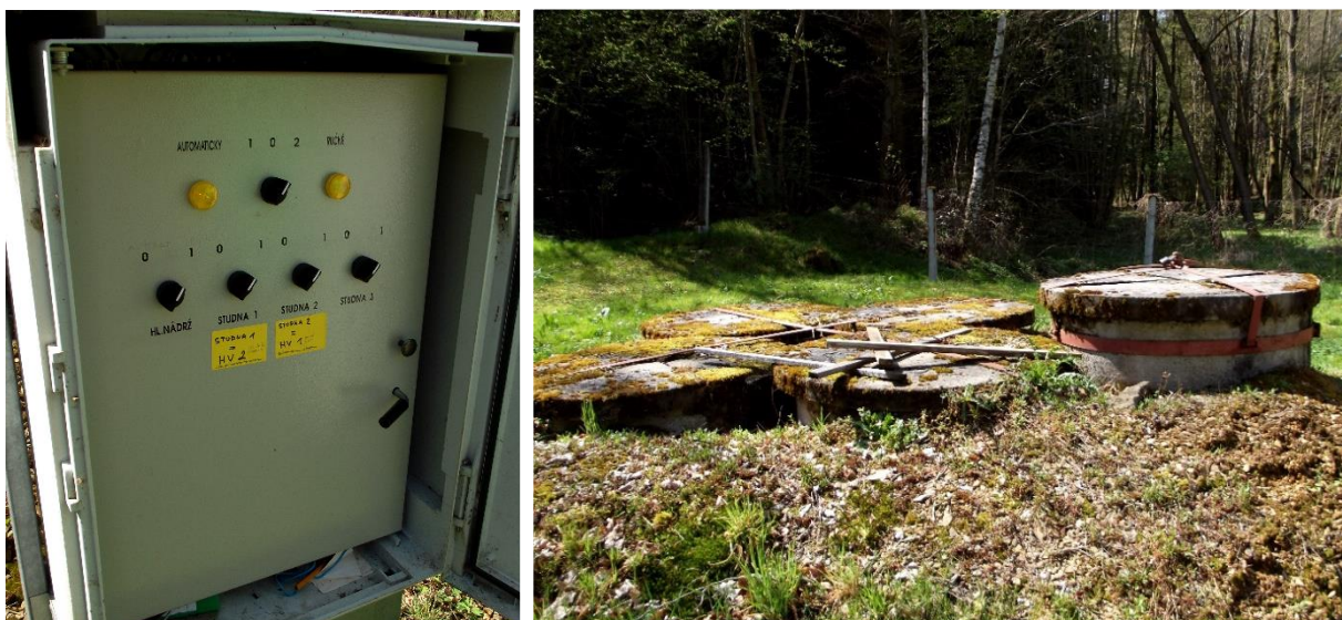
Obr. 2.3 Rozvaděč a zabezpečení u přečerpávací nádrže.
