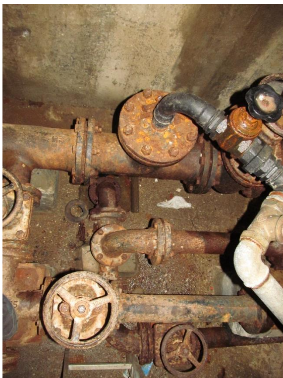
Obr. 2.10 Nevyhovující technický stav armatur ve vodojemu.
