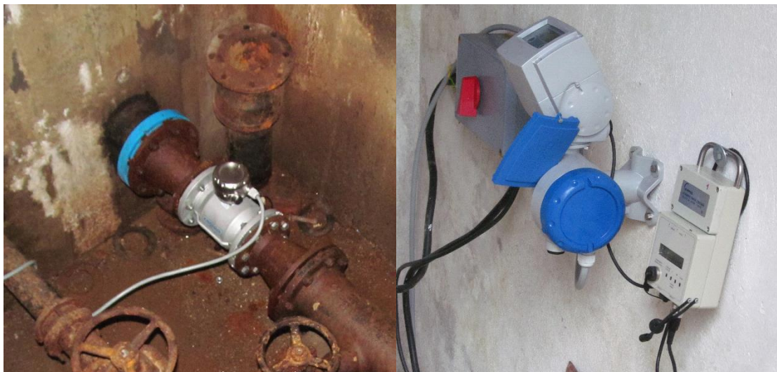
Obr. 2.9 Osazení průtokoměru ve vodojemu a záznamník naměřených hodnot.
