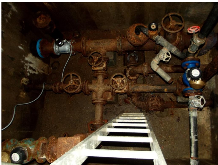
Obr. 2.6 Pohled na výstroj armaturní komory vodojemu.
