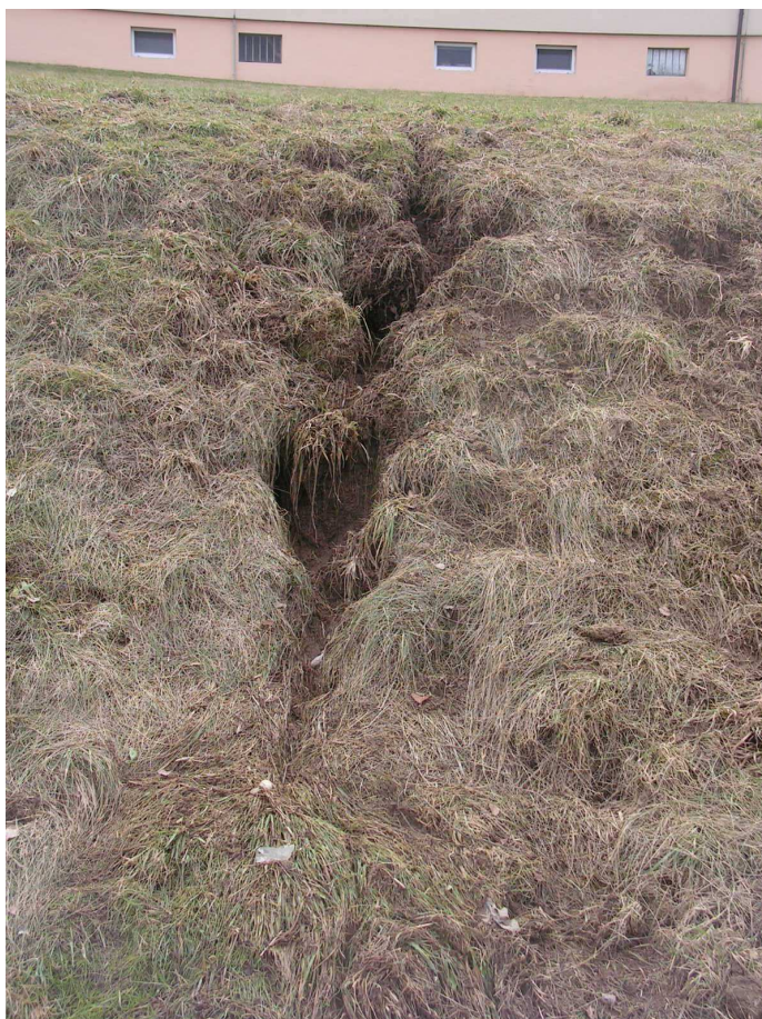
Obr. č. 5: Vznik erozní rýhy (foto: Filip Machula, březen 2010)
