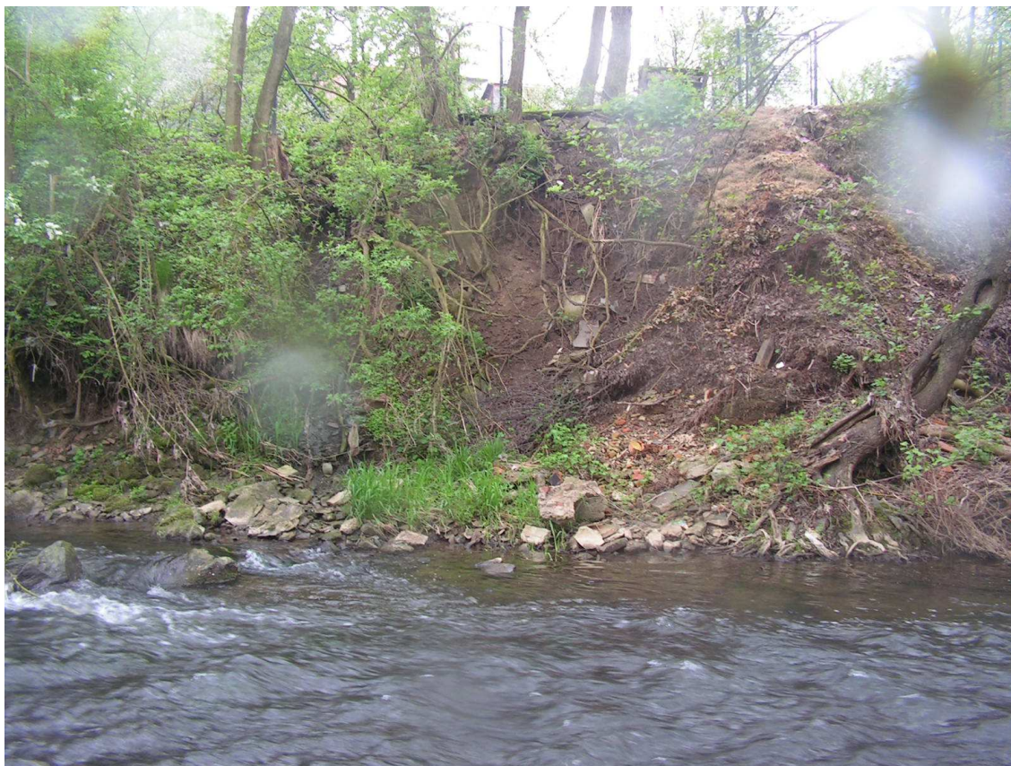
Obr. č. 22: Břehová nátrž na řece Dřevnici v lokalitě Zlín – Lůžkovice (foto: Filip Machula, duben 2010)
