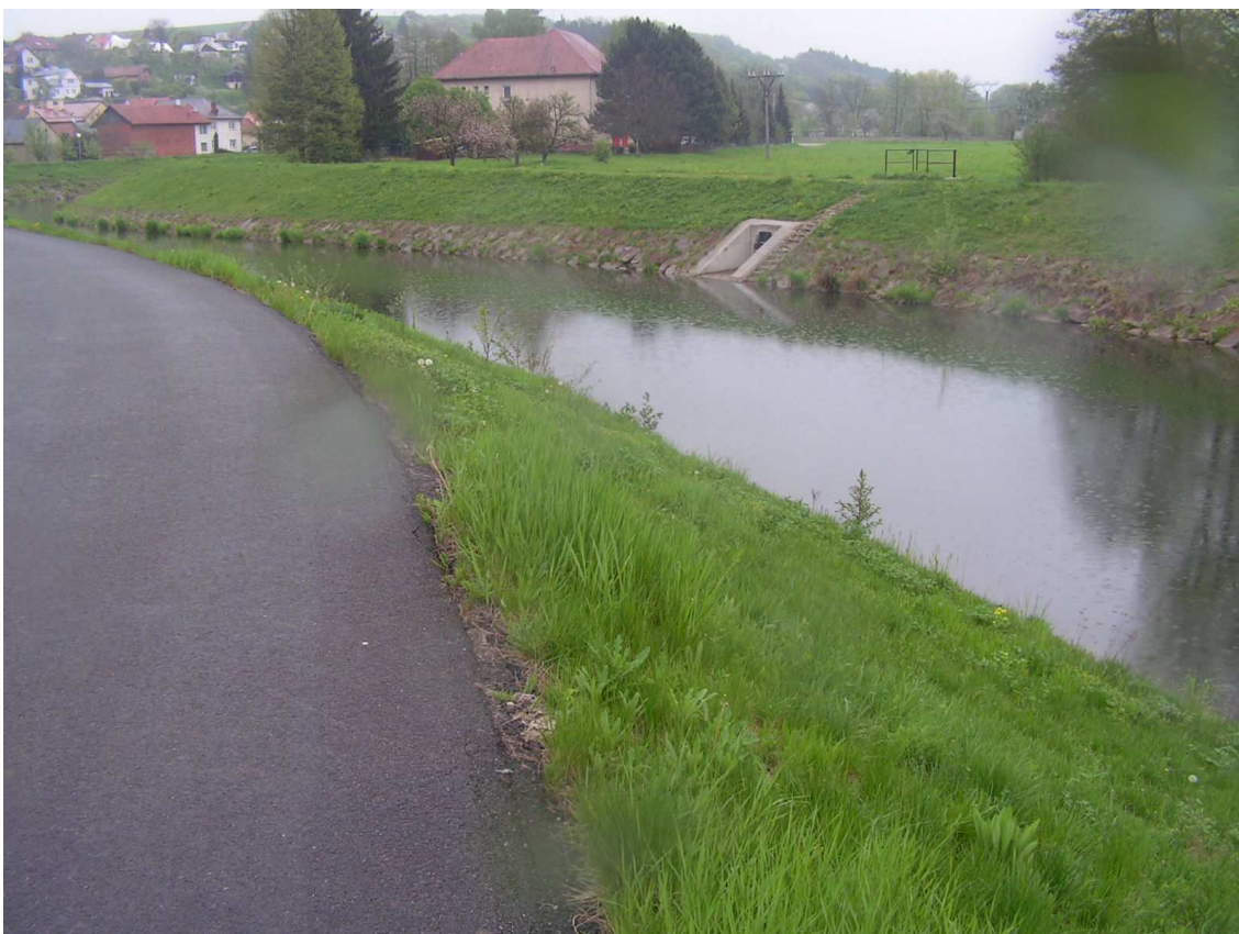
Obr. č. 81: Hráz regulovaného koryta chráněná pískovcovými bloky proti erozi břehů (foto: Filip Machula, duben 2010).
