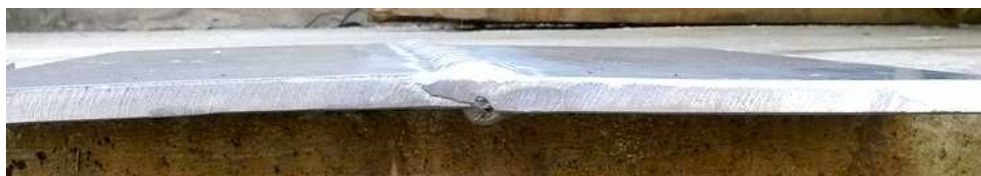
Obrázek 75 Tlusté plechy bez viditelné deformace, vlastní zdroj
