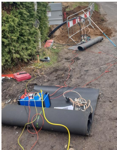
Obrázek 7-12 Připojení měřicí soustavy ke zkušebnímu vedení
