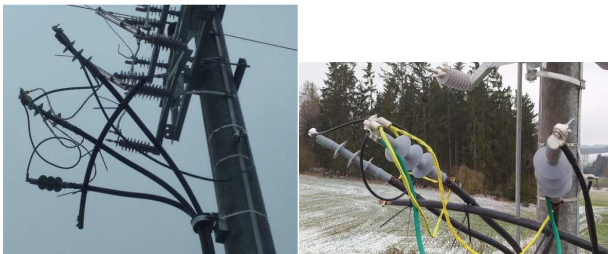
Obrázek 7-9 Uzemnění kabelového vedení u sloupu
