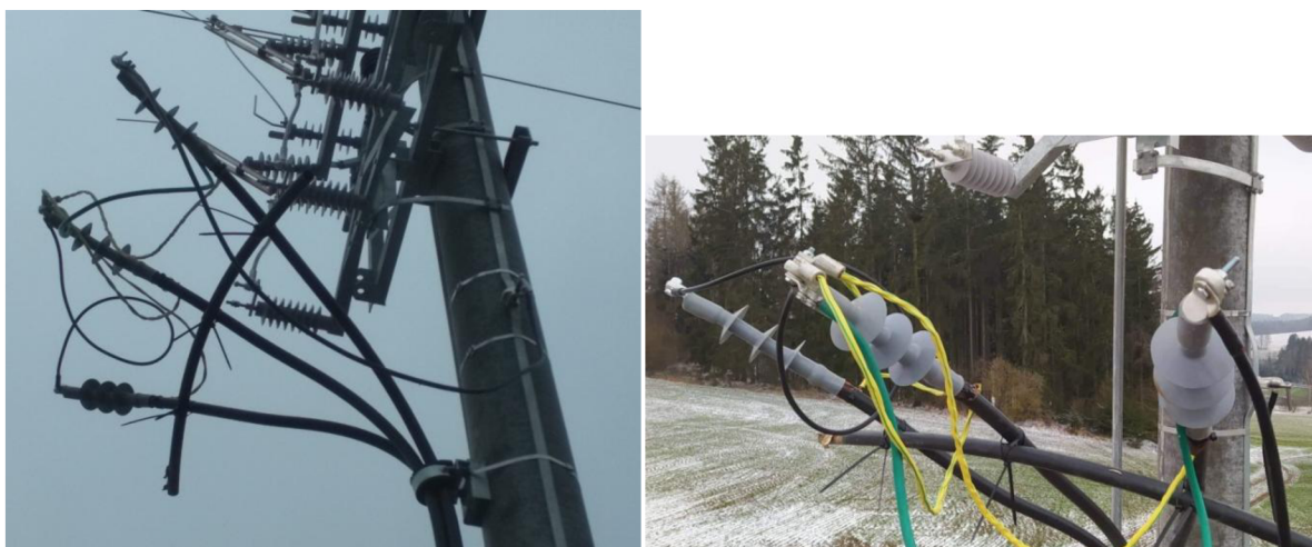
Obrázek 7-9 Uzemnění kabelového vedení u sloupu
