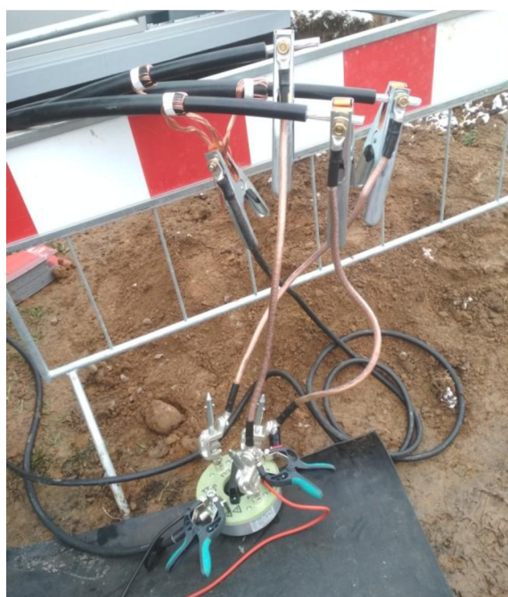
Obrázek 7-10 Připojení kabelového vedení k CP GB1
