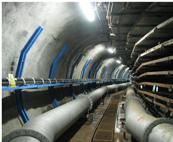
Obrázek 3-2 Uložení kabelového vedení 110 kV v kolektoru [2]
