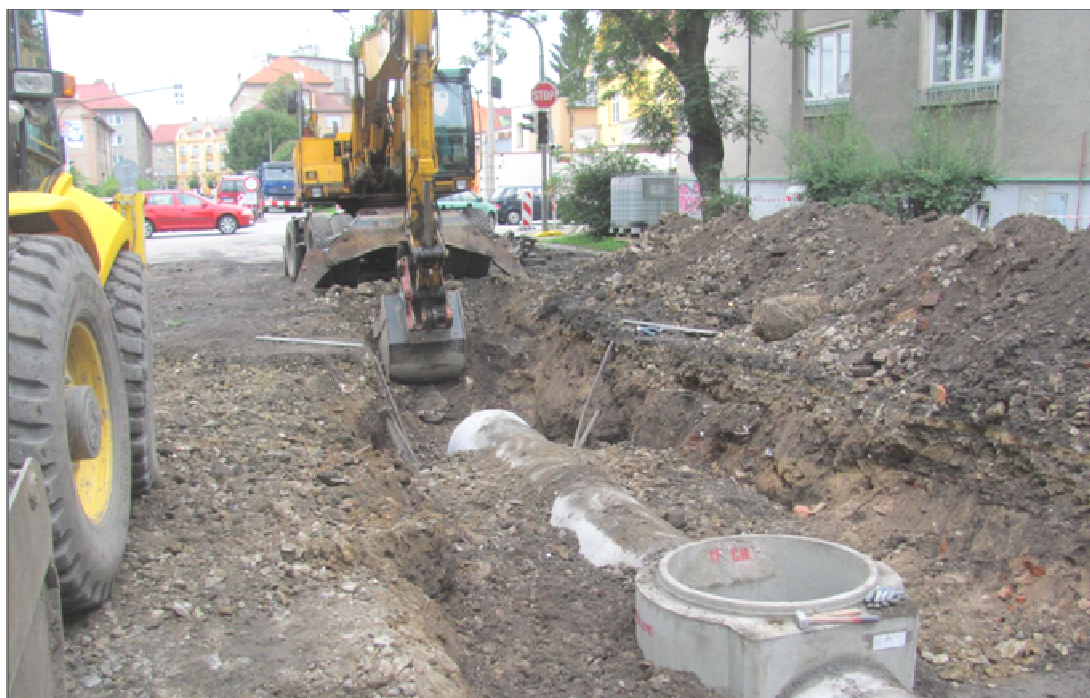
foto č. 5 Čechova III – Š9, spodní díl prefabrikované šachty, betonové potrubí DN 600
