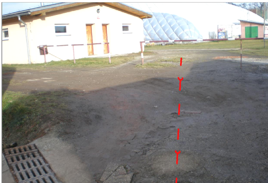
foto č. 3 Pohled proti spádu navrhovaného sběrače od stávající šachty k šachtě Š1, trasa zakreslena červeně
