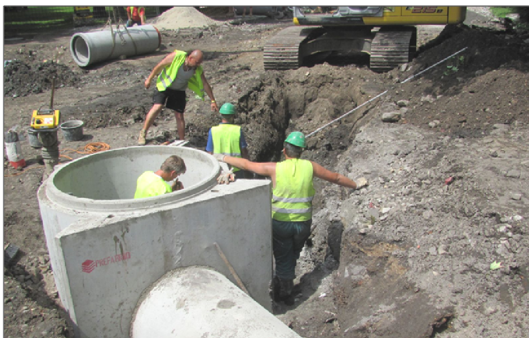
foto č. 6 Čechova III – Š10, spodní díl prefabrikované šachty, betonové potrubí DN 600
