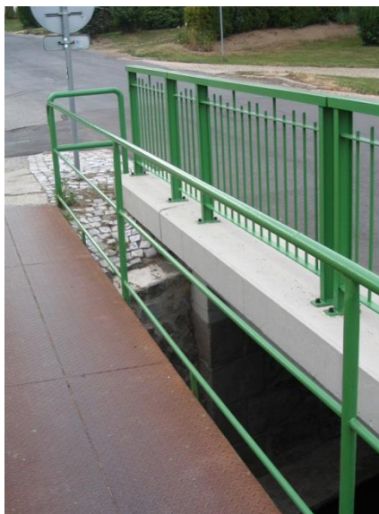
Obrázek 7 - římsy, zábradlí mostu – pohled od souběžné lávky pro pěší [vlastní fotografie]
