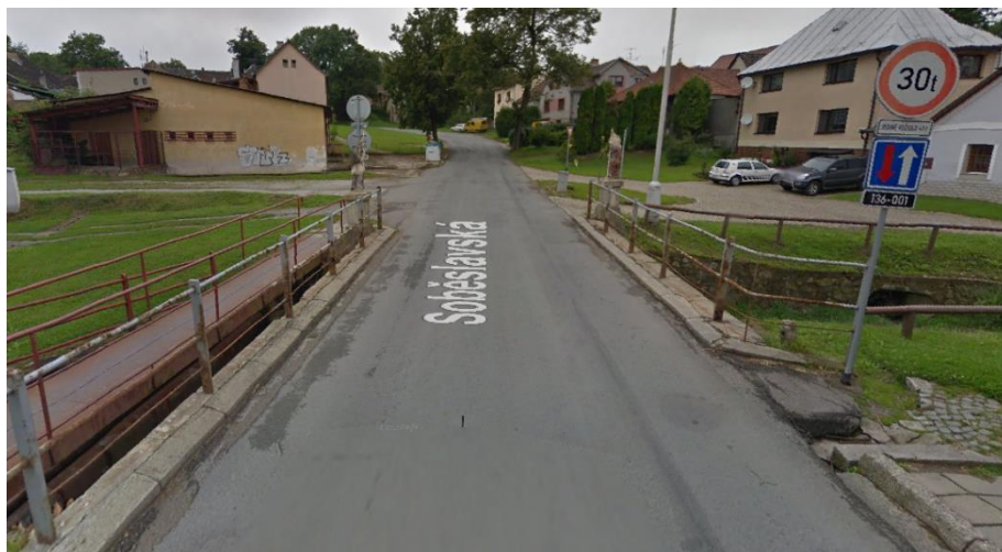
Obrázek 4 – most Černovice před rekonstrukcí [24]
