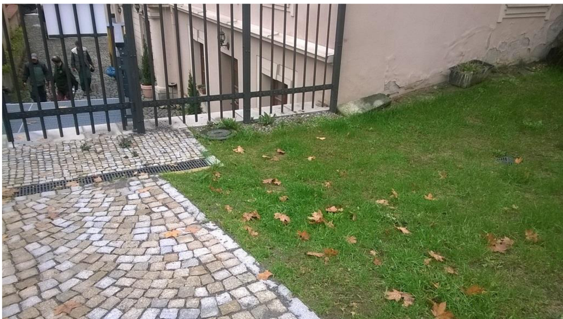
Obrázek 18 - pásová vpust, šachta – odvodnění parkánu [vlastní fotografie]
