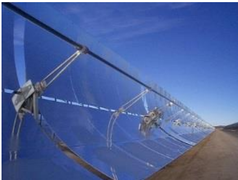
Obrázek 11: Příklad žlabového sběrače FV elektrárny [11]
