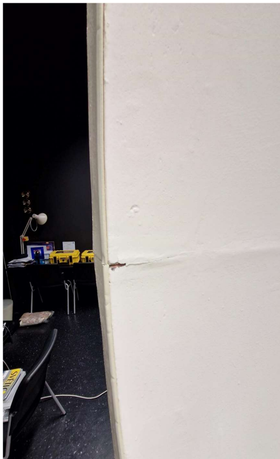
Obr. 26: Fotodokumentace – detail defektu pláště pohyblivé polokoule
