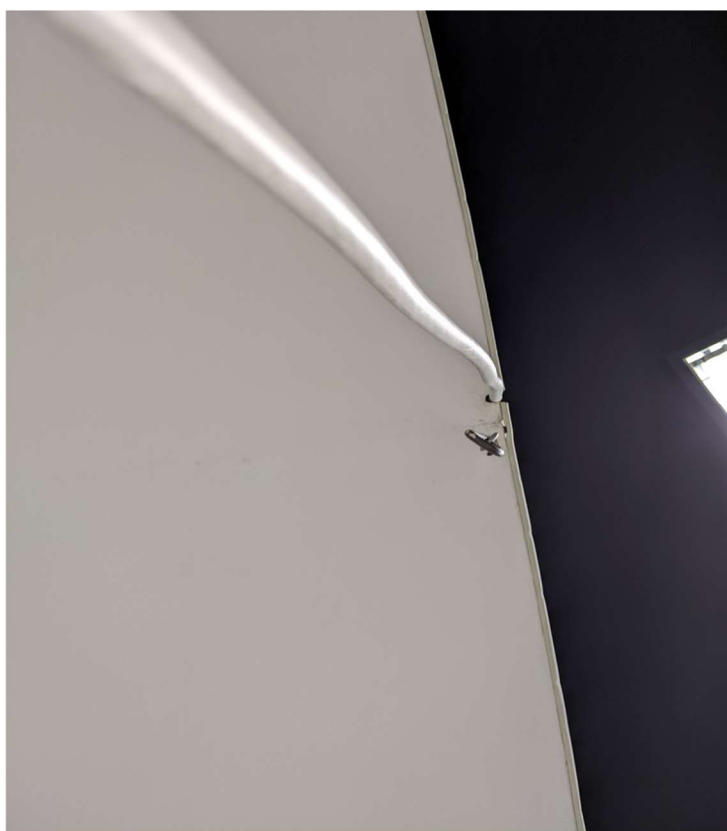
Obr. 22: Fotodokumentace – skoba a elektrický přívod
