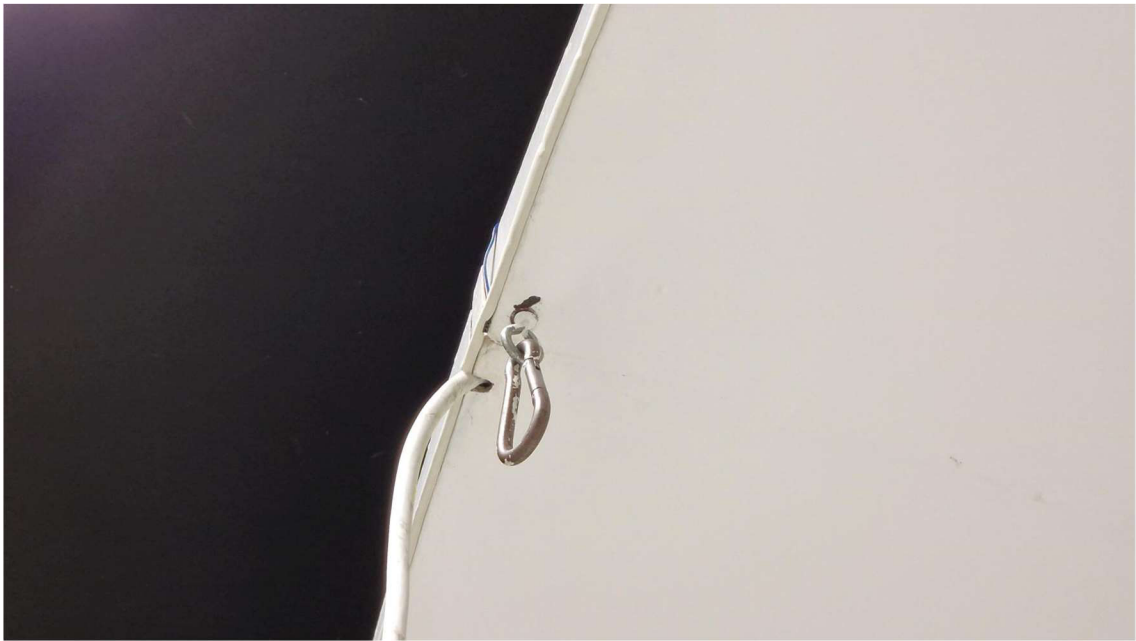
Obr. 25: Fotodokumentace – skoba pro zavěšení svítidel a elektrický přívod – detail
