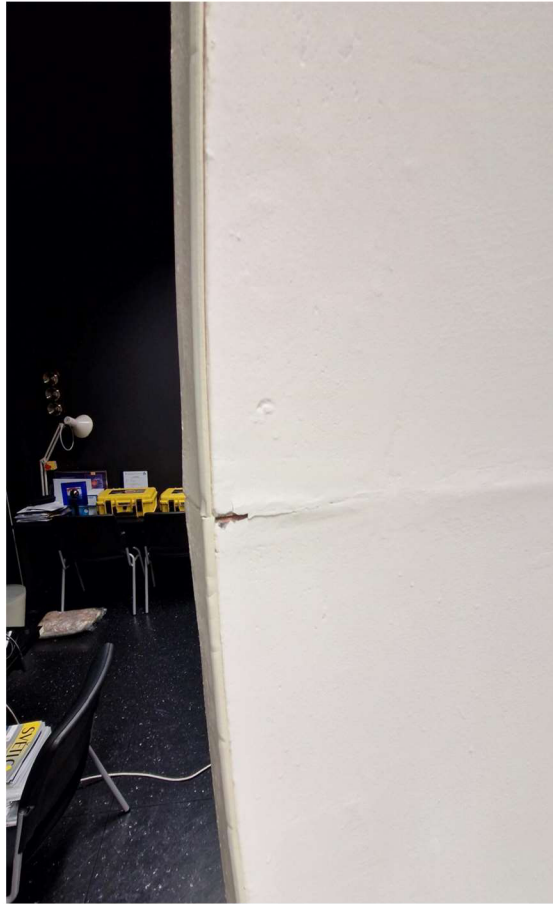
Obr. 26: Fotodokumentace – detail defektu pláště pohyblivé polokoule
