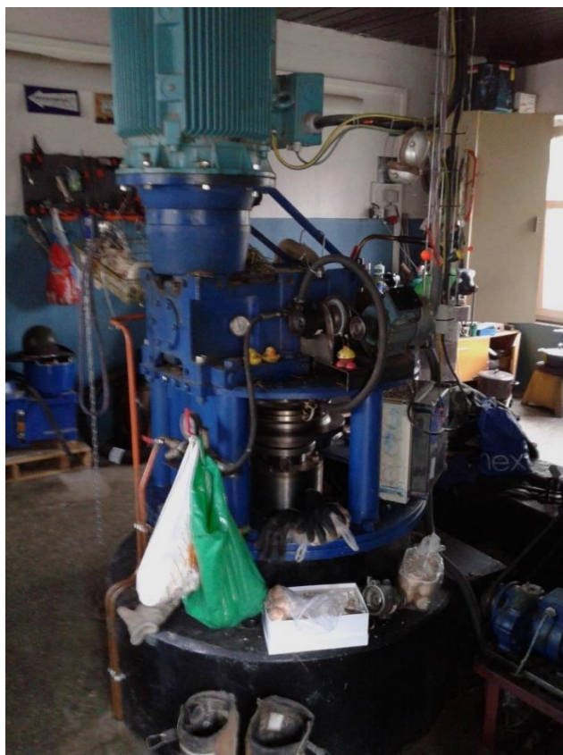
Obr. 4.6 Foto vybavení strojovny [vlastní zdroj]
