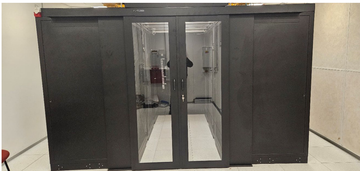
Obr 21 Fotka serveru v High-tech technologickém-výukovém pavilonu Fakulty lesnické a dřevařské na České zemědělské univerzitě
