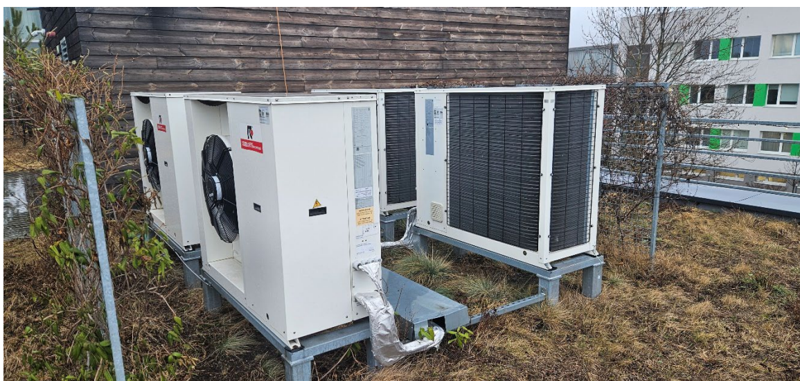
Obr 22 Fotka chilleru na střeše High-tech technologickém-výukovém pavilonu Fakulty lesnické a dřevařské na České zemědělské univerzitě
