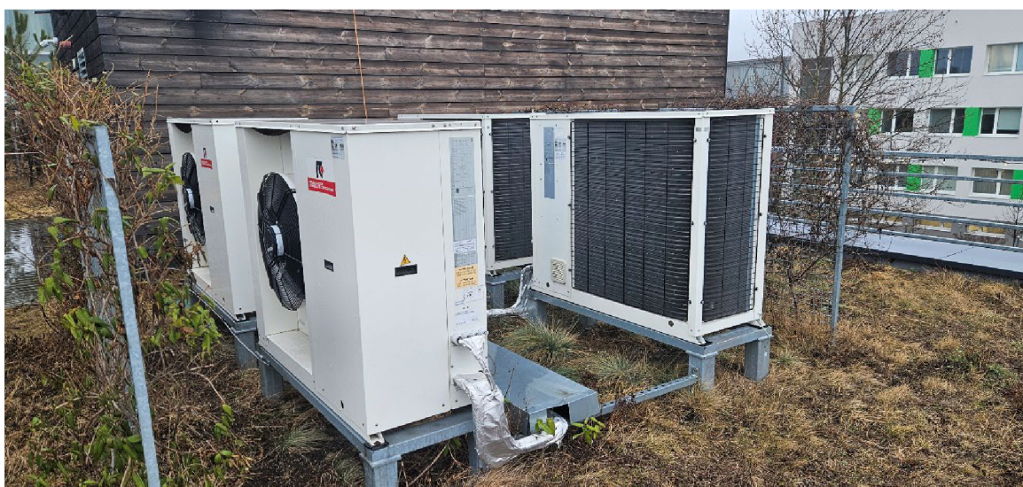
Obr 22 Fotka chilleru na střeše High-tech technologickém-výukovém pavilonu Fakulty lesnické a dřevařské na České zemědělské univerzitě
