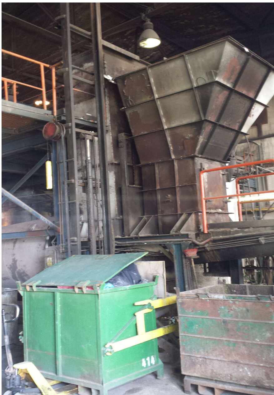
Obr. č. 9: Skipový výtah kontejneru s odpadem, zásobníkem odpadů, dávkovací komora
