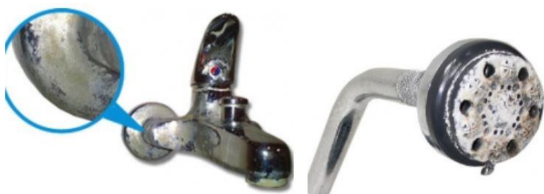
Obr. 2 Vodní kámen na armaturách [5]
