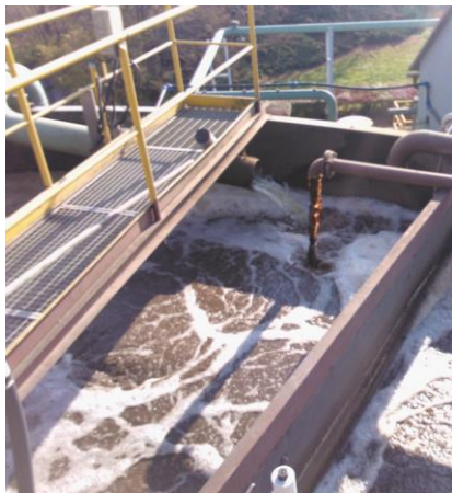
Obr. 67 – Denitrifikační část s přívodem surové studené vody, nátokem z ANR reaktoru a přívodem recyklovaného kalu (Opava) [47]
