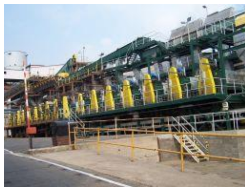
Obr. 21 – Stanice řízkolisů (Dobruška) [29]
