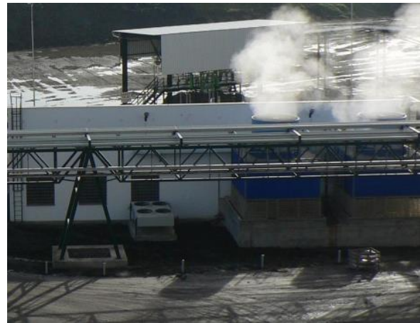
Obr. 74 – Ventilátorové chladicí věže (Dobrovice) [58]
