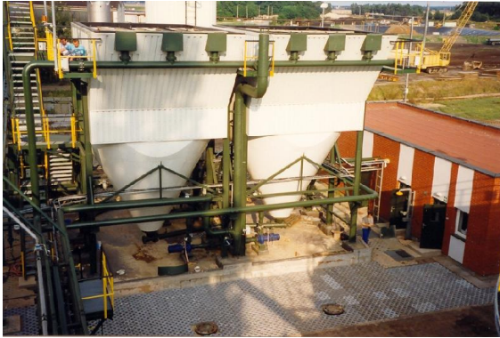
Obr. 61 – Lamelové usazovávky ČOV (Brottewitz) [53]
