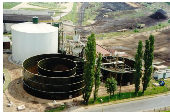
Obr. 64 – Anaerobní stupeň ČOV se třemi nádržemi (Brottewitz) [53]
