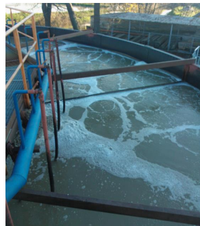
Obr. 68 – Nitrifikační část s přívodem stlačeného vzduchu-modré potrubí (Vrbátky) [47]
