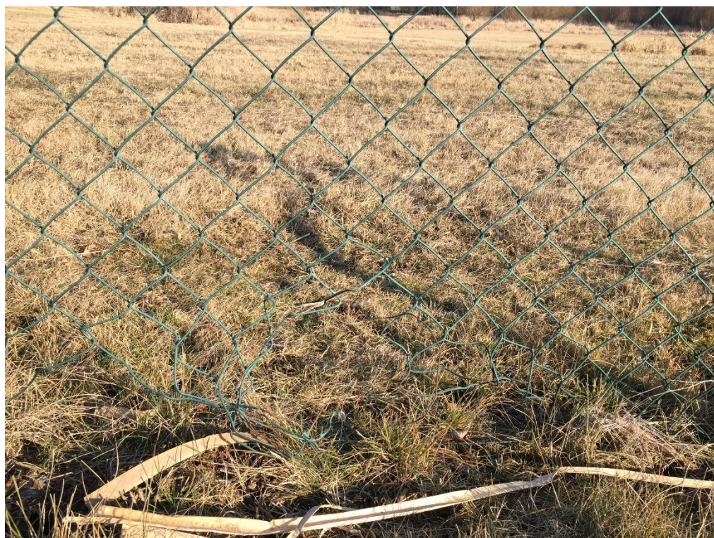
Obr. 6: Škody způsobené na KČOV Sedlečko zvěří – poškozené oplocení (Zdroj: Vlastní)
