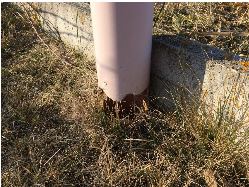
Obr. 5: Škody způsobené na KČOV Sedlečko zvěří – okusy potrubí (Zdroj: Vlastní)
