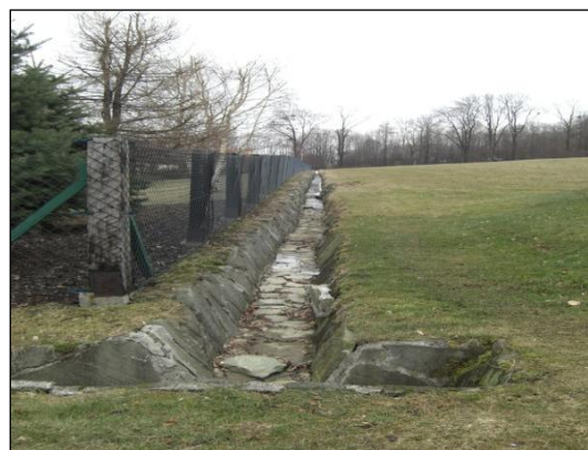
Obr. 42 Odvodňovací příkop u rodinného domu v Komorní Lhotce
