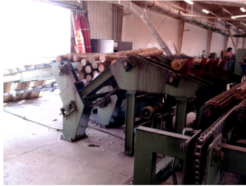
Obr. 10 Pilnice II. – elevátor s dávkováním
