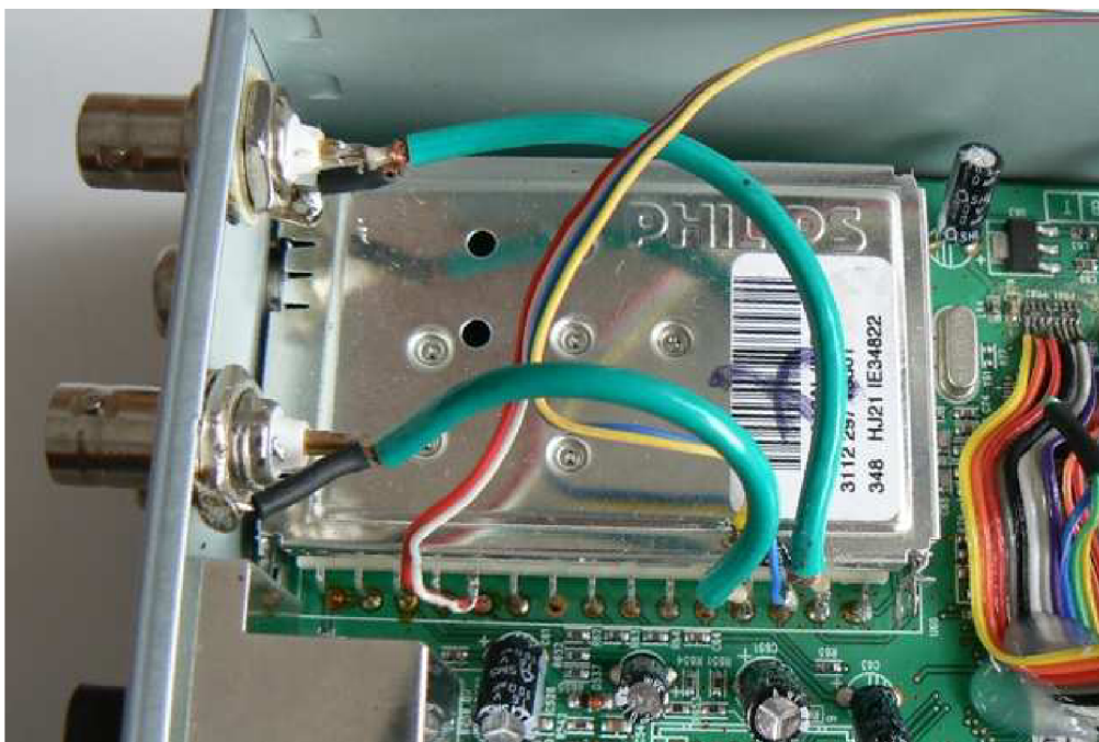
Obr. 42 Pohled na měřící a spínací vývody tuneru
