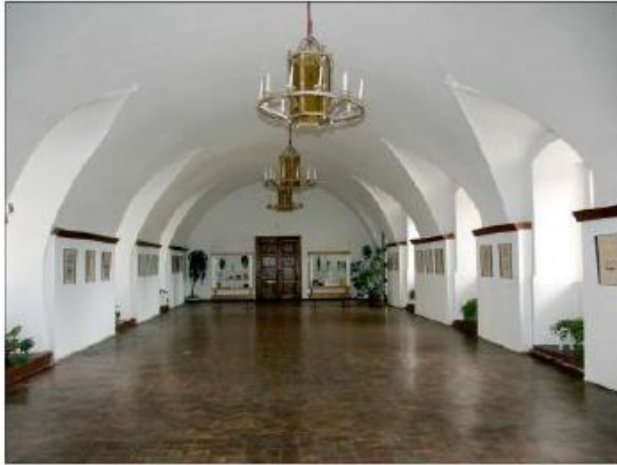
47. Renesanční prostor bývalé konírny v západním křídle zámku zaklenutý valenou půlkruhovou klenbou
