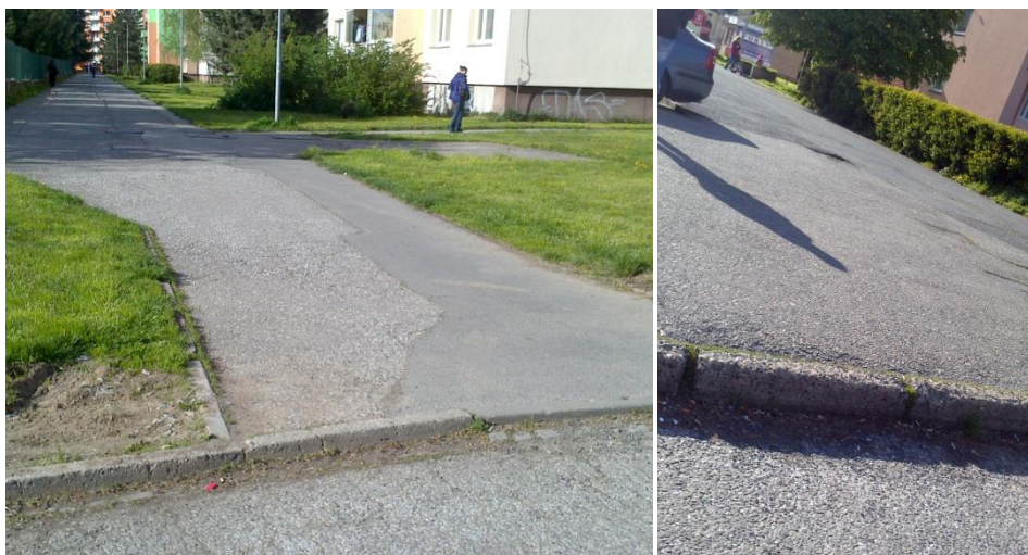
Obr. 85 a 86 Dva vysoké obrubníky na sídlišti Povel v okolí ulice Lužická, kde by se dalo realizovat výše zmíněné opatření (zdroj: Haničinec, 2016).
