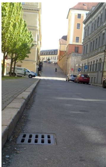
Obr. 87 Jeden z příkladů nevhodně orientovaných poklopů kanalizace nacházející se na ulici Hanáckého pluku (zdroj: Haničinec, 2016).
