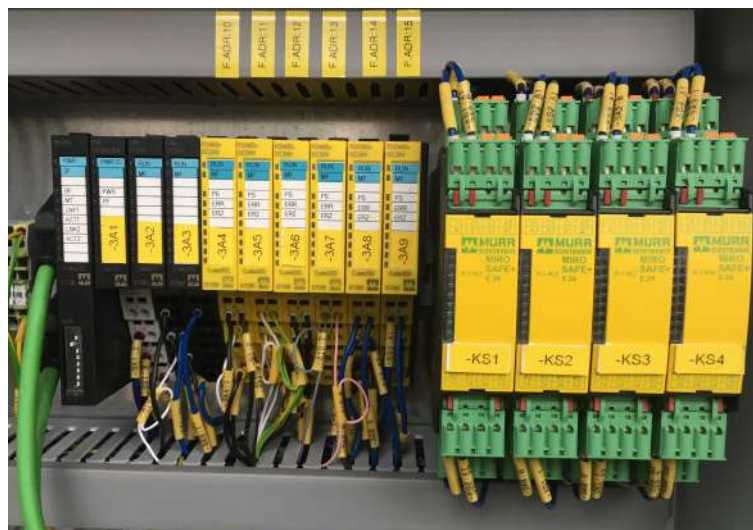
Obr. 3.10: Rozšiřovací moduly MIRO SAFE a I/O moduly pro PLC
